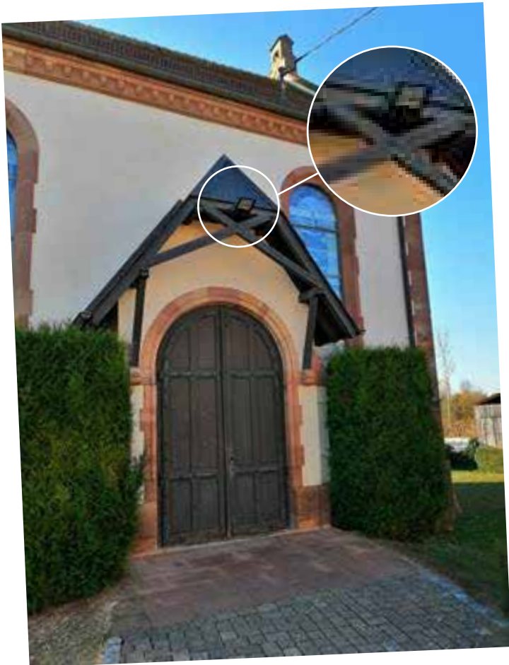
Remplacement du projecteur à l'entrée de l'Eglise
